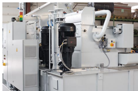
Filtre à cuve profonde avec non-tissé sur installation combinée
